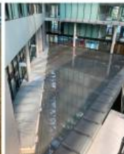
TeinDecken / Wasseranlage (außen/innen)
